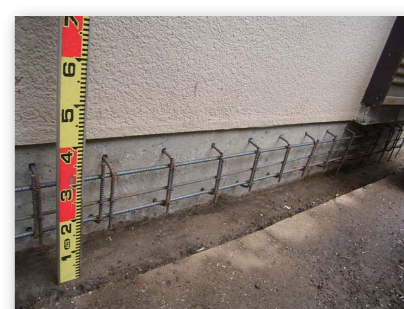
既存基礎の補強 (写真は鉄筋コンクリート基礎の増し打ち)
